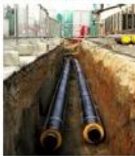
Réseau de chaleur
