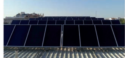
22/08/2014 Instalación de los colectores solares en un solo día. Colectores de grandes dimensiones Solvis.
