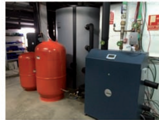
Estratificador, Estación Solar, Unidad SolvisVital3 y control
