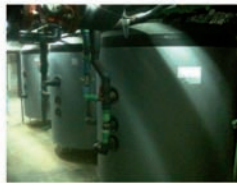
Acumuladores de ACS
