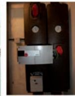
Plus - Estación carga Energía de caldera a estratificador
