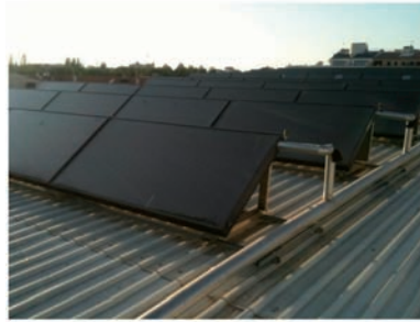
Instalación previa. Deficiencias en conexiones. En el primer invierno falló el sistema externo de disipación. Desde entonces no funcionó el sistema solar.
