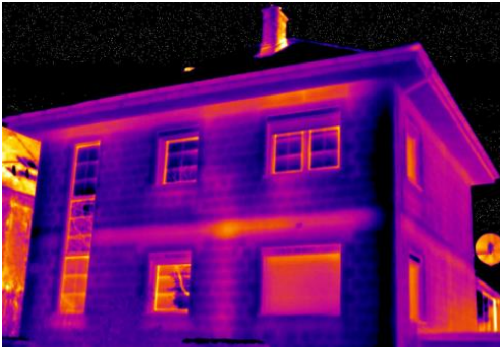
Figura 2: termografía en invierno de la envolvente de una vivienda unifamiliar
