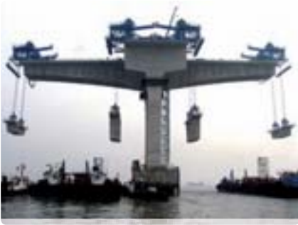
Construcción de un puente off-shore mediante el empleo de cajones prefabricados de hormigón para la formación del tablero.
